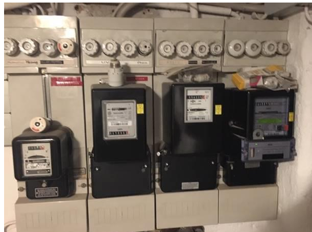
Abbildung 7: Zählerplatz, an dem grundsätzlich der Austausch der Zähler gegen eine moderne bidirektionale Messeinrichtung möglich ist, aber ...
