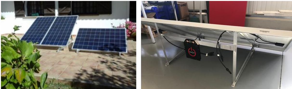
Abbildung 1: Beispiele für Mini-PV-Anlagen, im rechten Bild in der Bildmitte der zur Anlage gehörende Wechselrichter, Quelle: BeOn
