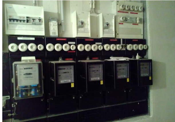
Abbildung 6: Zählerplatz, der bei einem Umbau der Elektroinstallation zu modernisieren wäre
