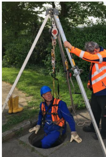
Abbildung 4 Der Abstieg in den Schacht erfolgt durch den Ableser, der gesichert über den Seilzug (Dreibein) von einer zweiten Person im Notfall geborgen werden kann (Quelle: E-MAKS).
