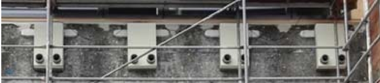
Abbildung 7: Foto der Demoanlage (außen) an Raum 301.
