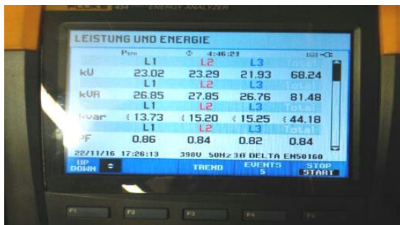
Abbildung 8 Messung Energieanalysator Fluke
