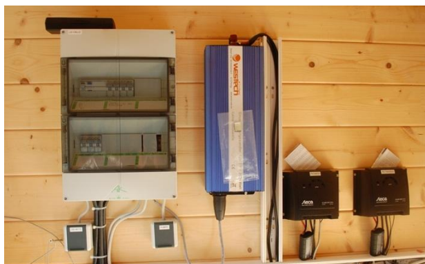
Das Herzstück der Photovoltaikinsellösung, von links: Sicherungsschrank, Wechselrichter, Laderegler
