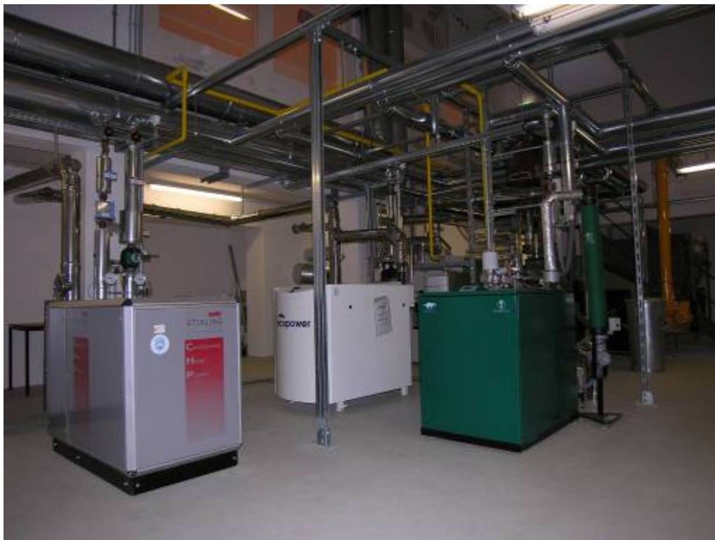
Links: Stirlingmotor, Mitte: ecopower-BHKW , rechts: Senertec-BHKW
