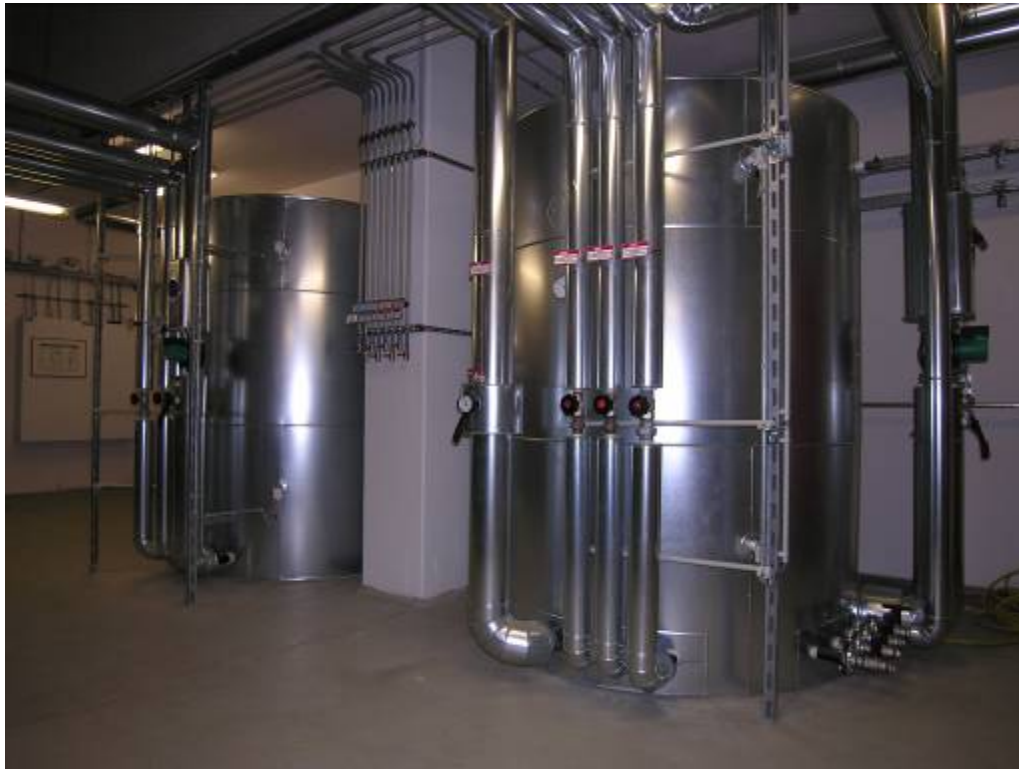
Links: Puffer mit Rücklaufanschlüssen, rechts: Puffer mit Vorlaufanschlüssen
