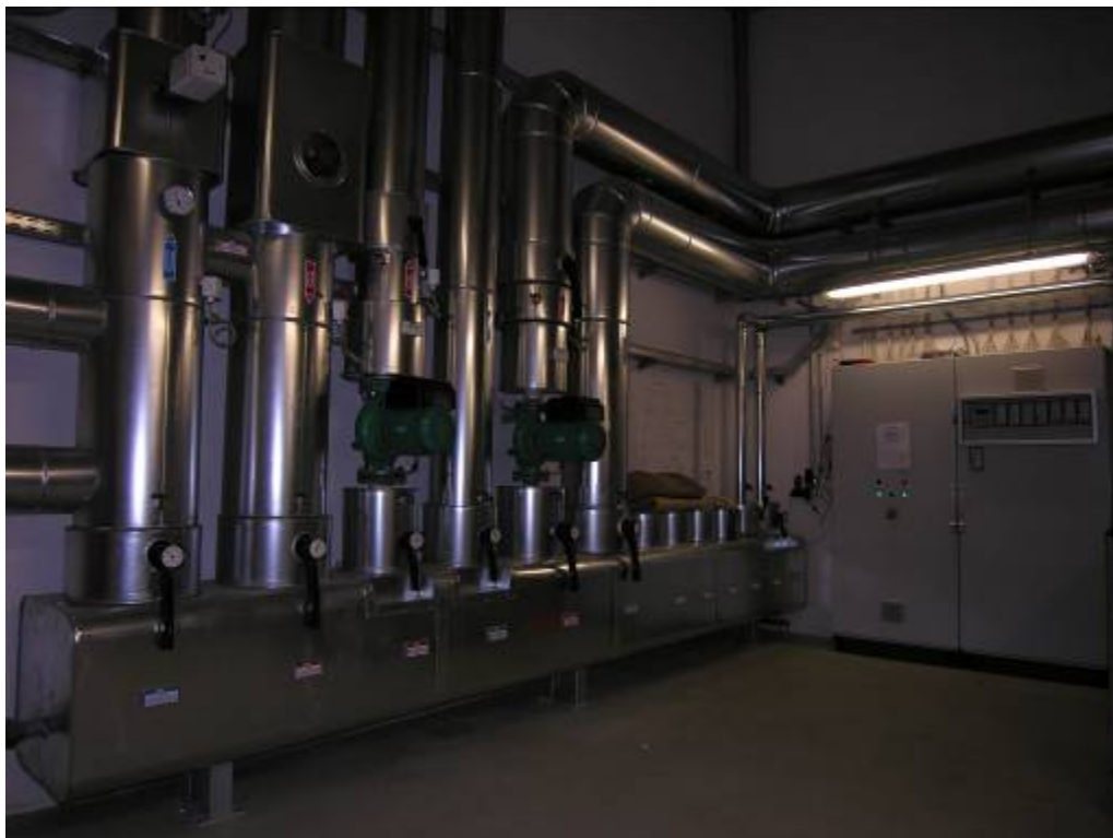
Links: Hauptverteiler, rechts: Schaltschrank
