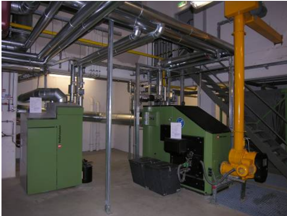
Links: Pelletskessel, rechts: Hackschnitzelkessel
