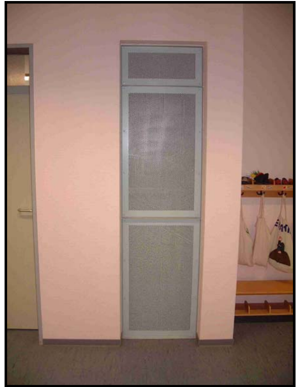
Blick auf einen Quellluftauslass
