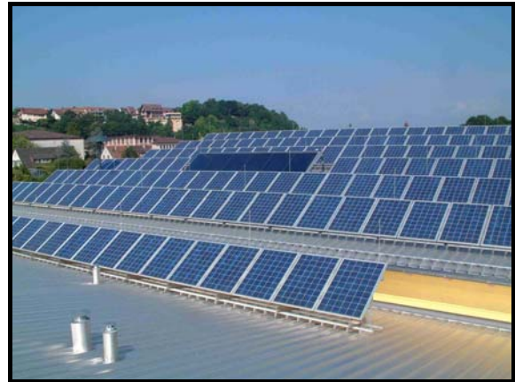
Blick auf die thermische Solaranlage inmitten der PV-Module
