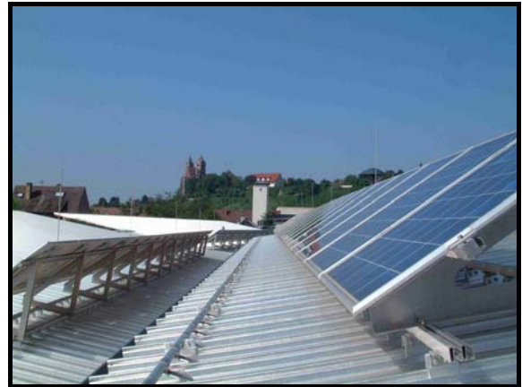
Blick auf Münster und die PV-Anlage
