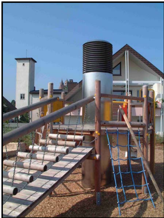
Ansaugturm der Zuluftanlage
