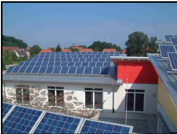
Blick auf die PV-Anlage
