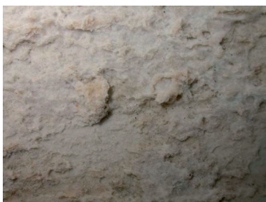
Abb. 26 Biofilmbildung nach Ablauf von 16 Tagen mit ca. 1÷2 mm Auftragsstärke
